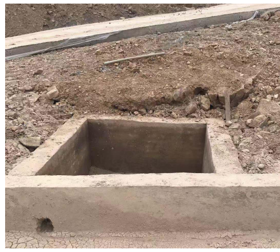
洗车配套沉淀池
