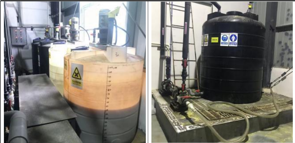
污水处理站药剂罐
