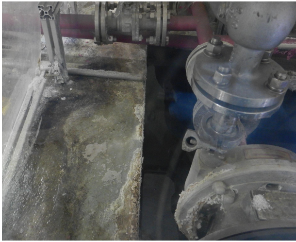
生产车间管道阀门跑冒滴漏情况
