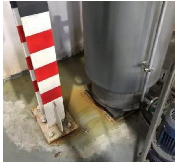
废水处理车间管道接口跑冒滴漏情况
