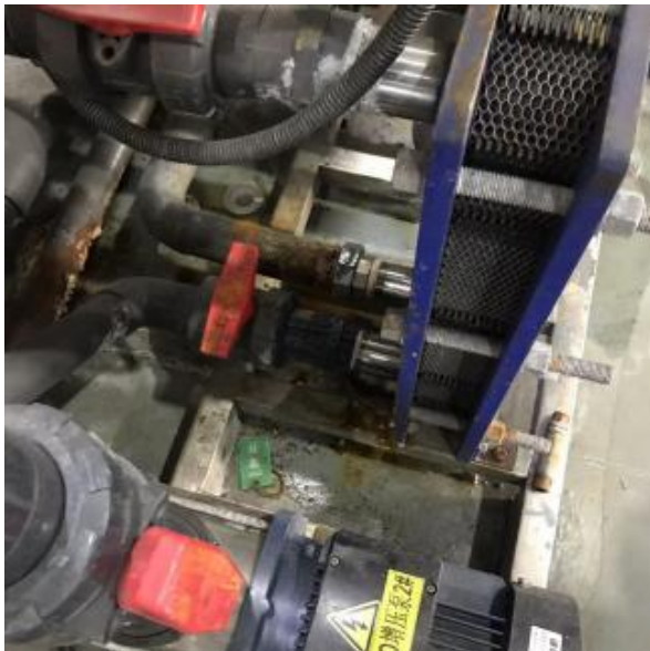
废水处理车间管道阀门接口跑冒滴漏情况
