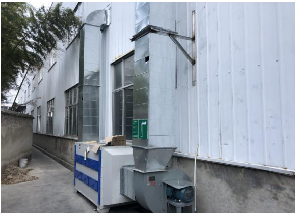
废气处理设施
